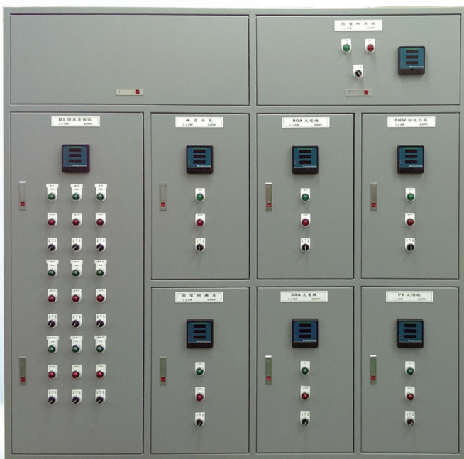
電能管理控制盤
